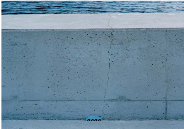
写真 1 予防が困難な温度ひび割れの例
