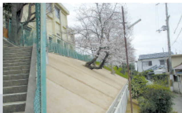
法面の保護工に施工した例。 土壌流失防止と防草の効果もある
